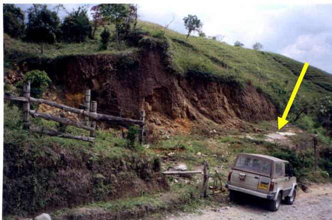
Fotografía 6. Detalle de los taludes verticales en el Barrio San Bernardino. La flecha indica la antigua posición de las viviendas reubicadas.
